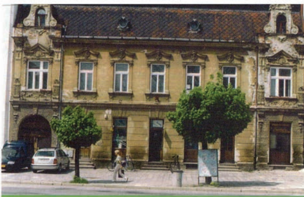
Obr. 1 Objekt před sanací vlhkého zdiva
