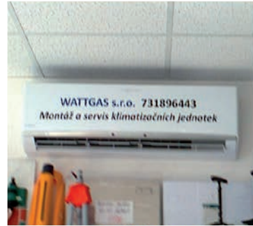
Klimatizační a topné jednotky
