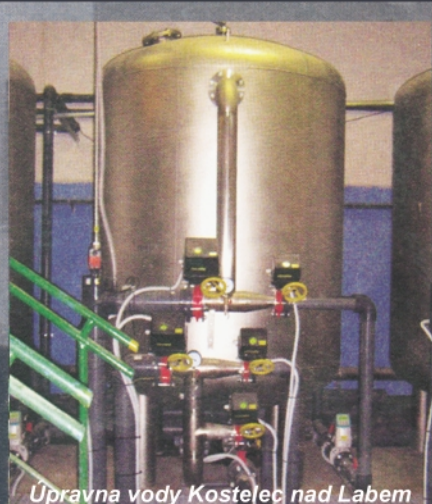
Úpravna vody Kostelec nad Labem
