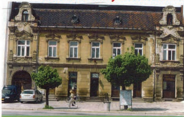
Obr. 1 Objekt před sanací vlhkého zdiva
