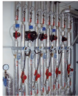
Tepelná čerpadla včetně vyřízení dotace
