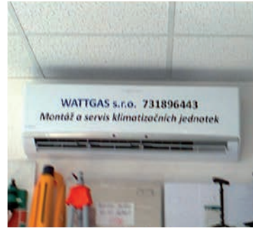
Klimatizační a topné jednotky
