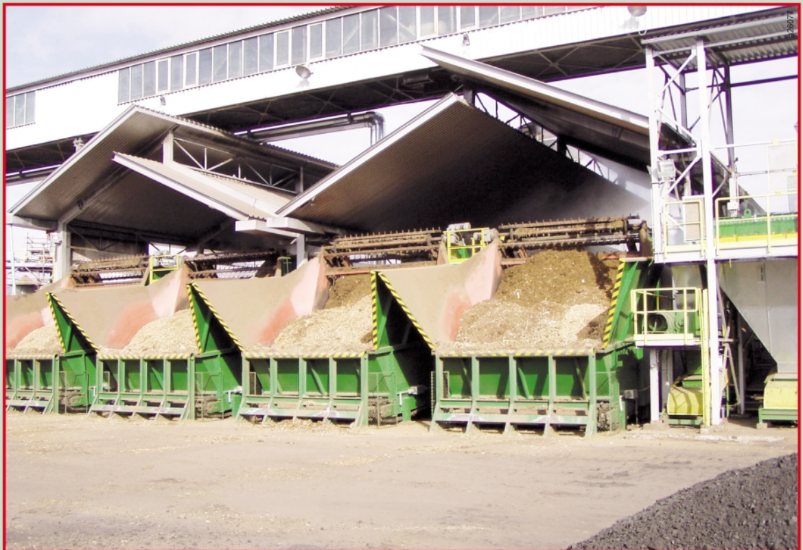
4 ks sušárny dřevěné štěpky, typ TARPO BS-16 pro Plzeňskou teplárenskou a.s.
